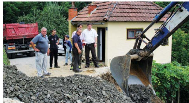
I ovog puta za sanaciju klizišta izostala je pomoć s državne razine
