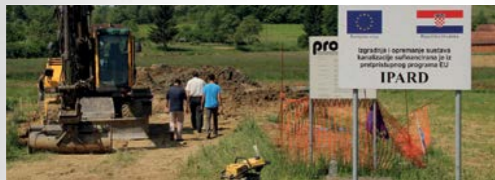
Pročištač u Kamenici nije tek dio komunalne infrastrukture već će značajno utjecati i na očuvanju okoliša
