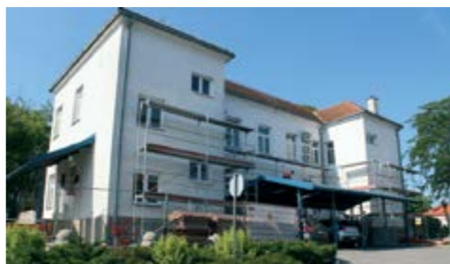
Radovi na energetskej obnovi zgrade gradske uprave bit će završeni na proljeće iduće godine
