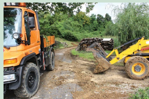
Dan nakon obilne kiše počela je hitna sanacija šteta
