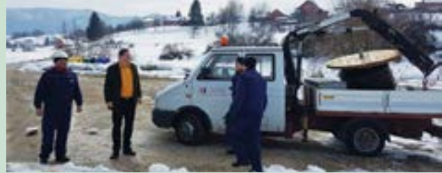
HEP reflektore na igralištima u Gečkovcu i Viletincu priključuju na NN mrežu
